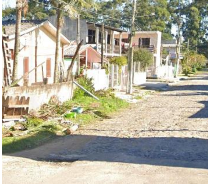
Figura 7 - Calçada em mal estado de conservação e com obstáculos
