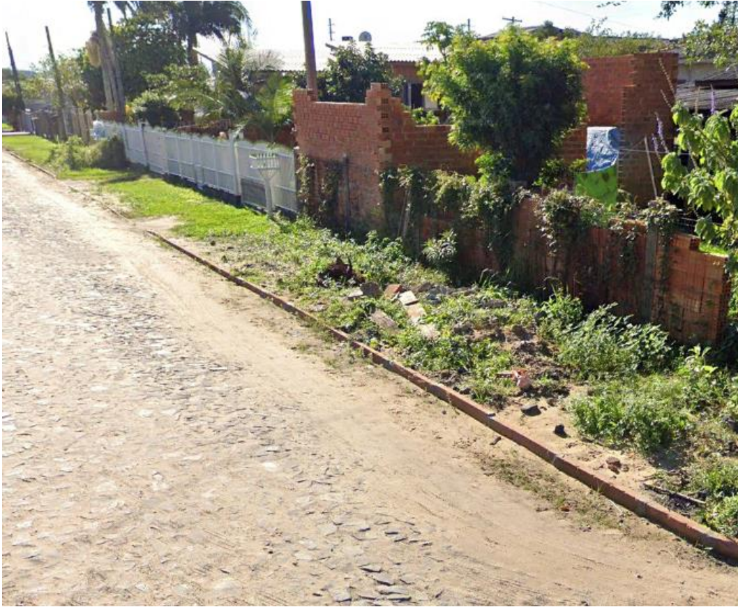
Figura 9 - Calçada em mal estado de conservação e com obstáculo
